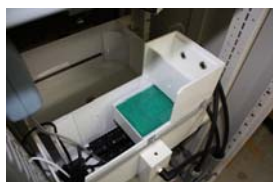
簡易ろ過器と簡易加温器 (監視水槽内に設置)
