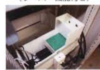
簡易加温器・簡易フィルター (監視水槽内に設置)
